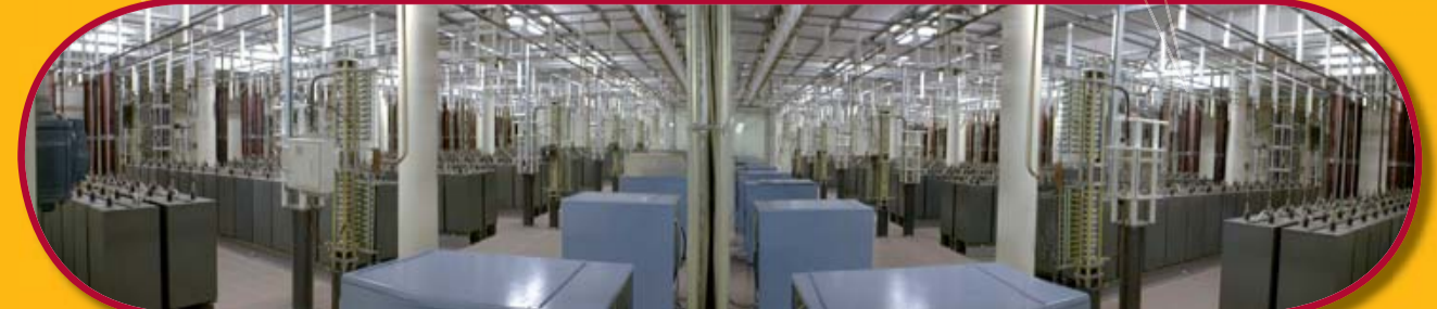
Batterie de condensateurs (connectée sur un électroaimant) permettant de produire des champs magnétiques intenses et pulsés © LNCMI, Toulouse
